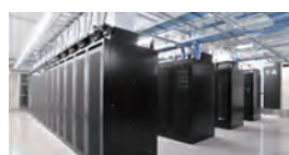
サーバーラック
