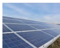
太陽光パネル架台
