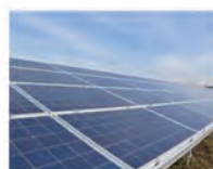
太陽光パネル架台
