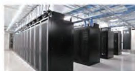
サーバーラック
